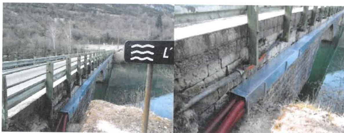
Exemple d'un passage de câbles HTA en encorbellement d'un ouvrage existant (Source : Tattu TP)
