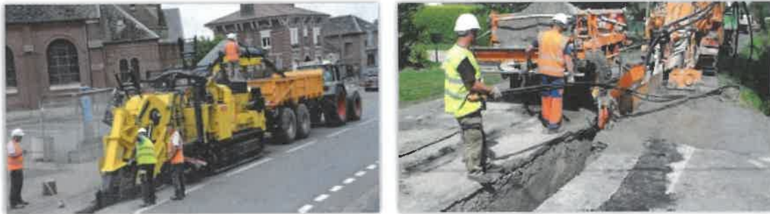
Illustration d'un passage de câbles électriques sous voirie (Source : La Voix du Nord, Ouest France)
